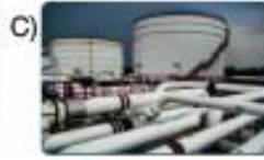
Doğal gaz boru hattı
